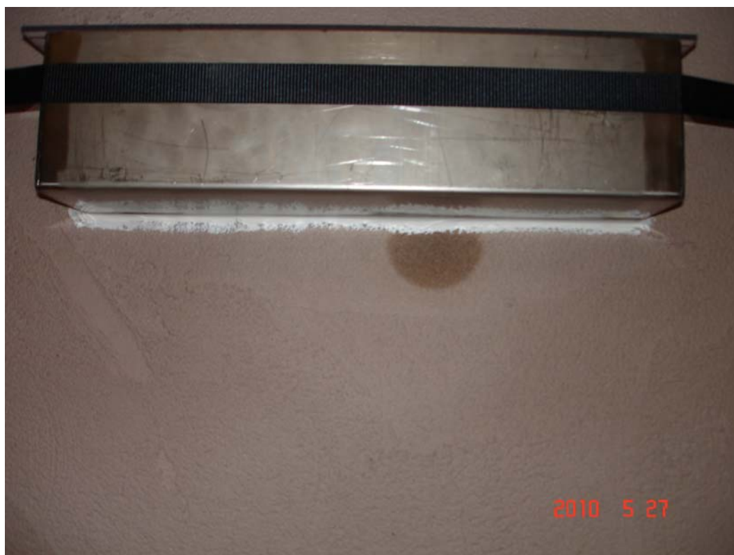
FOTO 6. Våt fläck under baljan.
