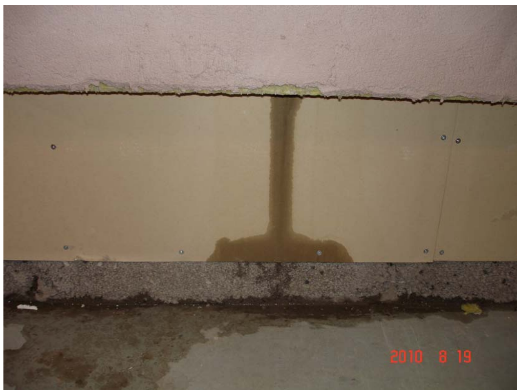
FOTO 8. Vattenflöde nedtill direkt under den vertikala skarven mellan mineralullsskivorna.
