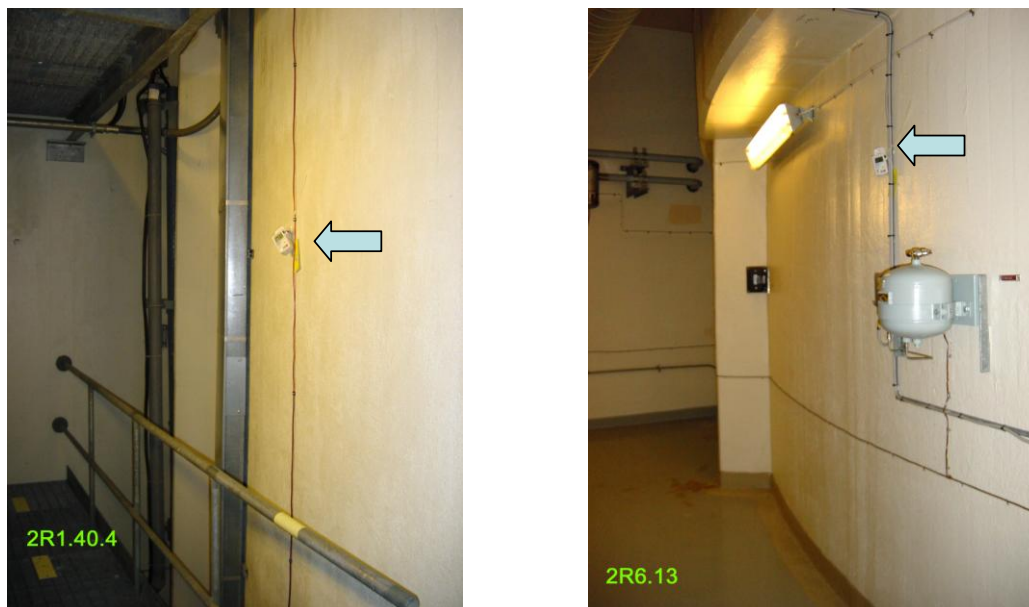
Fig. 5.1.3. Placering av dataloggrar i B2 på plan 4 i fyrkantsschaktet (vänstra bilden) och i utrymme under ringplatta (högra bilden).
