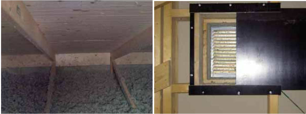
Bild 2. Ventilationen i vindsutrymmet är kraftigt reducerad genom "stängda" gavel- och takfotsöppningar.
