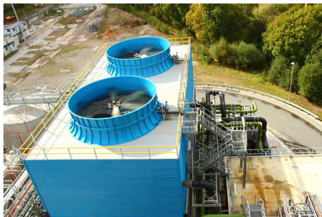
Kyltorn på en processindustriell anläggning.
