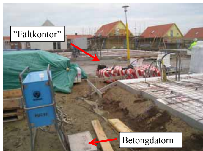
Figur 22. BetongDatorns centralenhet invid elcentral
