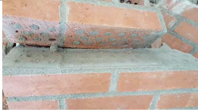
Bild 22. Närbild på den liggfog där brottet sker.
