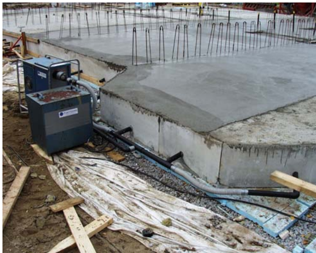
Figur 4.5 HP-systemet. Bilden visar turbinen som blåser in varm torr luft genom inblåsningsrören. Utblåsningsrören kan skyntas vid plattans mitt.
