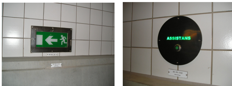
Figur 6. Vägledande markering och assistansknapp monterad i tunneln.
