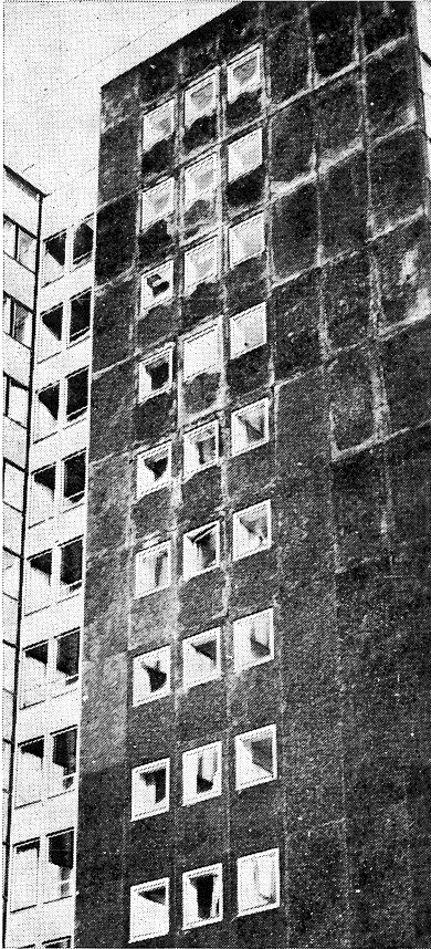
Fig. 1. Kondensation av fukt i husfasad.
