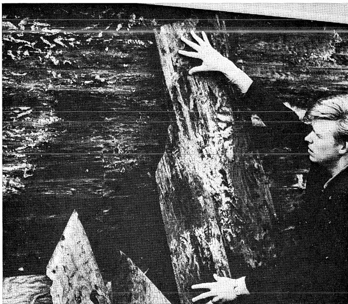
Fig. 9. Kondensation på innervägg med åtföljande rötskada.
