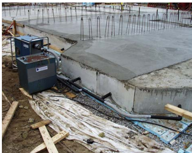
Figur 9.11 HP-systemet. Bilden visar turbinen som blåste in varm torr luft genom inblåsningsrören. Utblåsningsrören kan skimtas vid plattans mitt.
