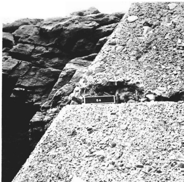
Fig 48. Fogskada och ytfrätning vid ca 25 år gammal stödmur vid regleringsdamm, uppströmssidan.
