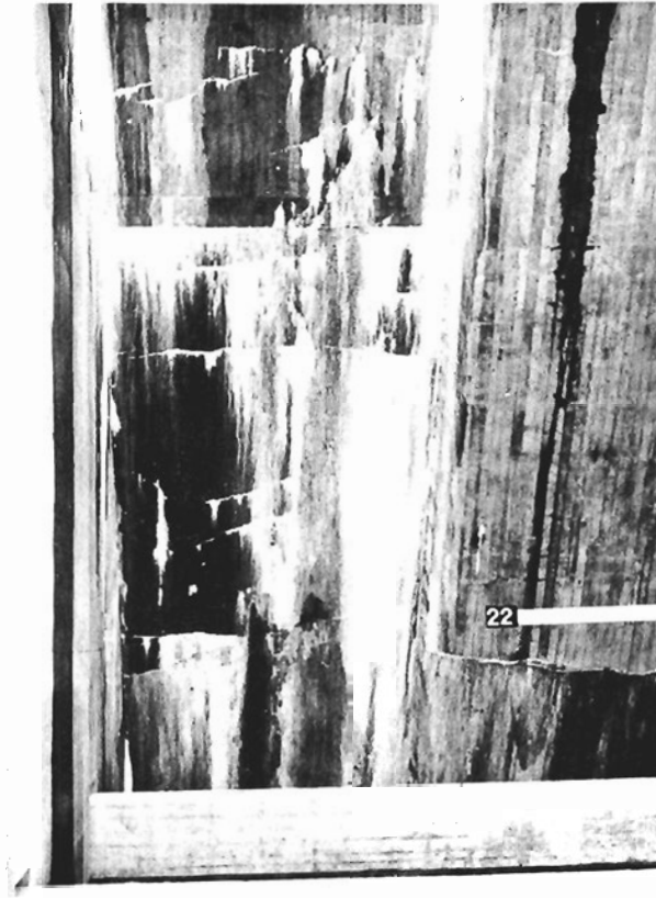
Fig 30a. Exempel på kalkutfällningar vid en damms nedströmssida (enl./33)
