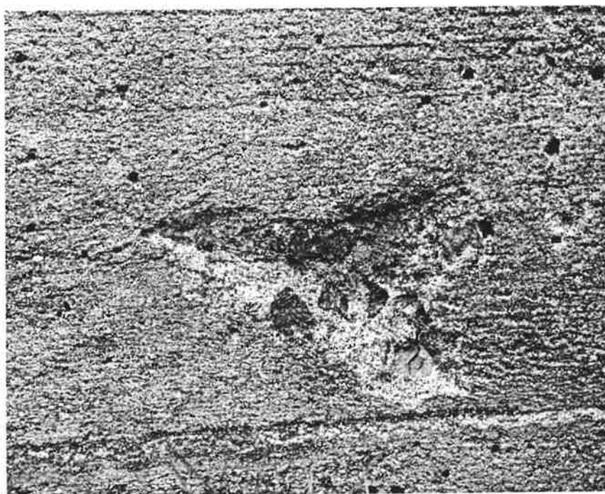
Figur B4 Exempel på skada orsakad av pop-out, lokaliserad på samma område som sprickorna i Figur B2.
