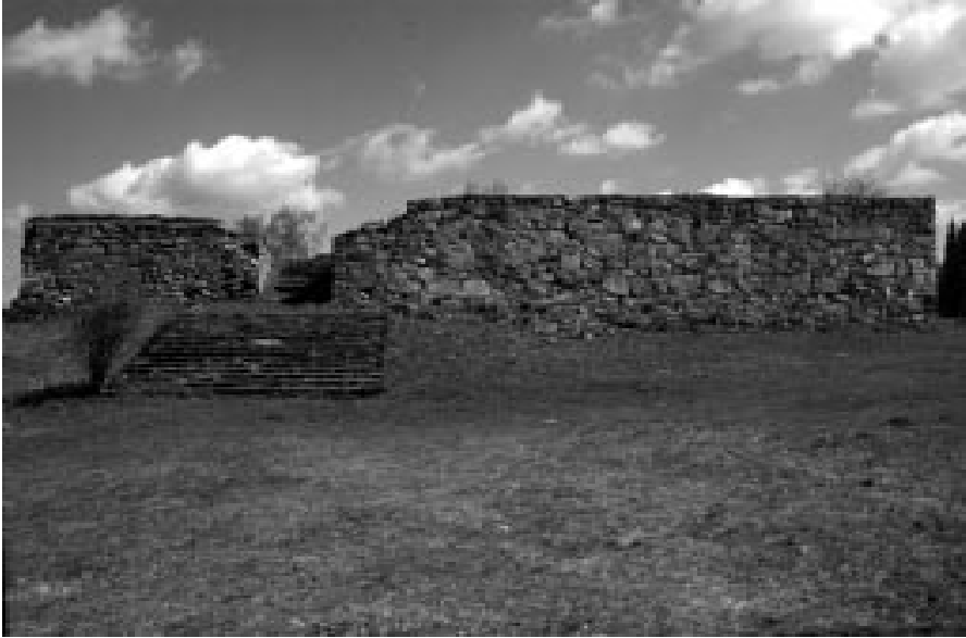
Fig. 100 "Borgen" på Hultaby med sin ca 4-4,5 meter höga "ringmur" mot borggården. Den breda paradtrappan är nästan nio meter bred. Foto förf.
