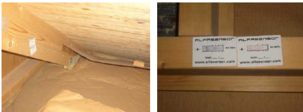
Figur 89 Indikatorer BI och HU placerade i par på kallvind. Indikator par nr 10 och 11 som alla visar fullt utslag efter två veckor.
