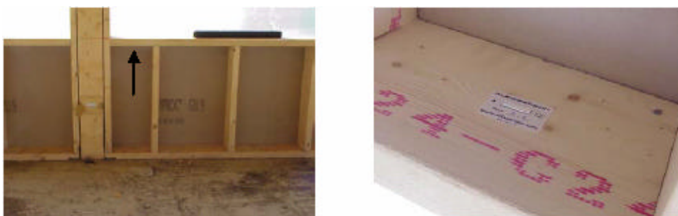
Figur 52 Placering av indikator för avläsning av utslag även efter att väggens insida färdigställs.
