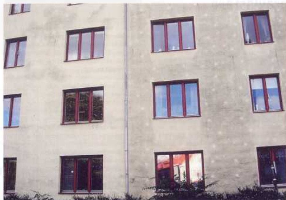
Bild 2: Fasad på byggnad i Kristianstad. Högra hälften har kraftig påväxt och vita prickar syns. Vänstra hälften har nästan ingen påväxt.
