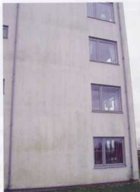
Bild 5: Fasad med påväxt av alg.
