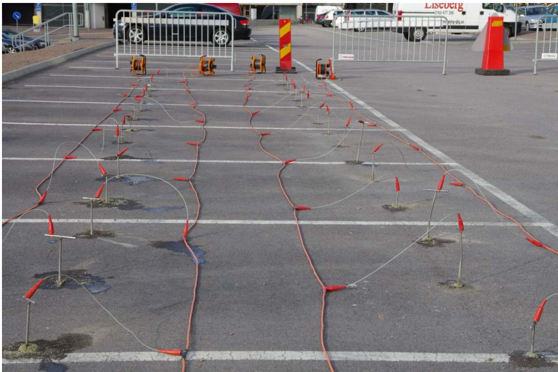
Figur 5. Fotografi från försöksområde 1 som visar elektroder installerade i borrhål genom asfalten och anslutna till elektrodkablar.
