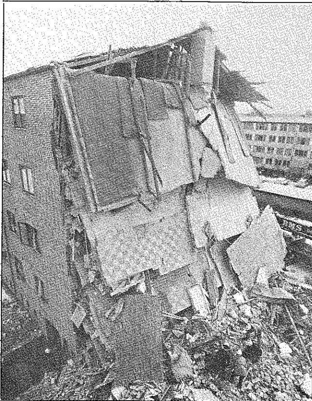
Fig 30. Fortskridande ras, orsakat av en gasexplosion i källaren i ett 4 våningars bostadshus i en av Københavns förorter, Skovlunde, den 2 december 1973
