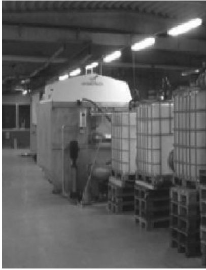
Figure 9 Pilot plant at Sjölanda WWTP, Malmö, Sweden.
