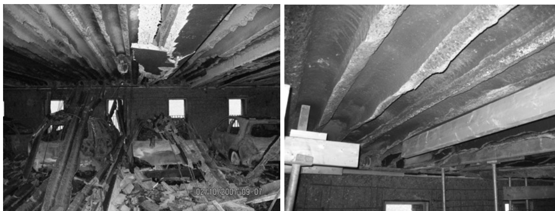
Figur 17 Skador på håldäcket efter branden i Rotterdam (Van Overbeek et al, 2010)
