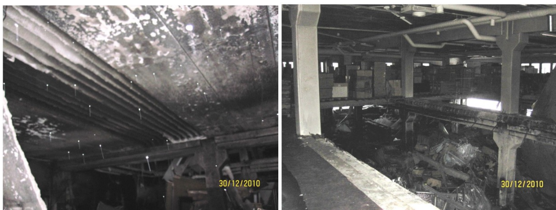
Figur 18 Skador på håldäck i Vantaa, Finland. Den vänstra bilden visar delaminering av den nedersta delen av ett håldäck, den högra bilden visar tomrummet efter kollapsen av håldäckssystemet (Lehtinun & Rasmus 2011).
