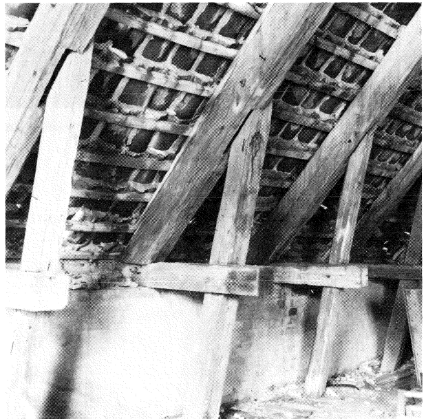
Fig. 5:3. Det ændrede tagværk i den bevarede del af sydfløjen, opbygget af genanvendt tømmer. (Foto: F. Beyer 1985.)
