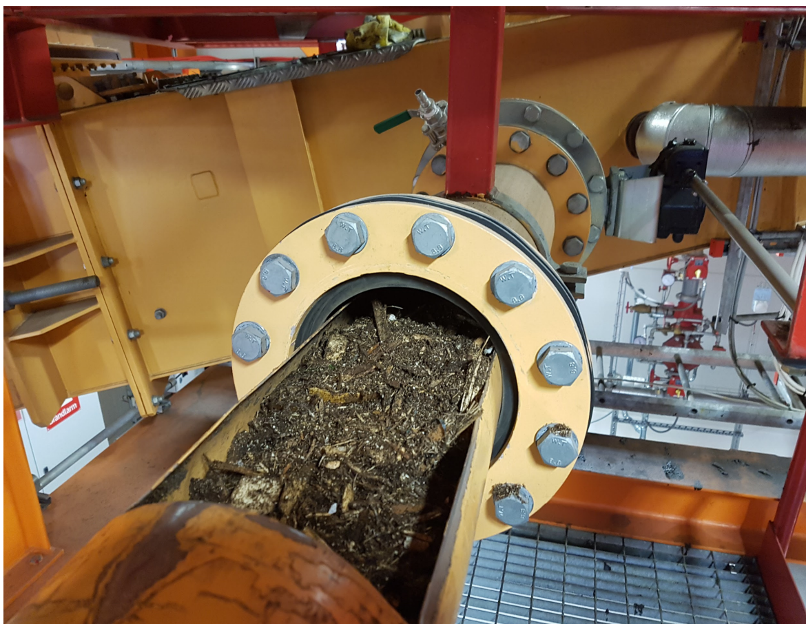
Figur B6. Ett fyllt provtagningsrör dras ut från bränsleutmatningen från silon. Bränsleutmatningen ses i bakgrunden där blandat bränsle kontinuerligt förs från botten av silon till pannan för förbränning.
