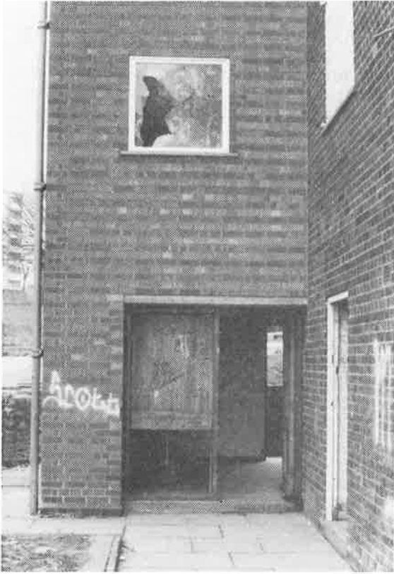
Söndriga fönsterrutor och igenspikade fönster fanns det gott om i detta bostadsområde.
