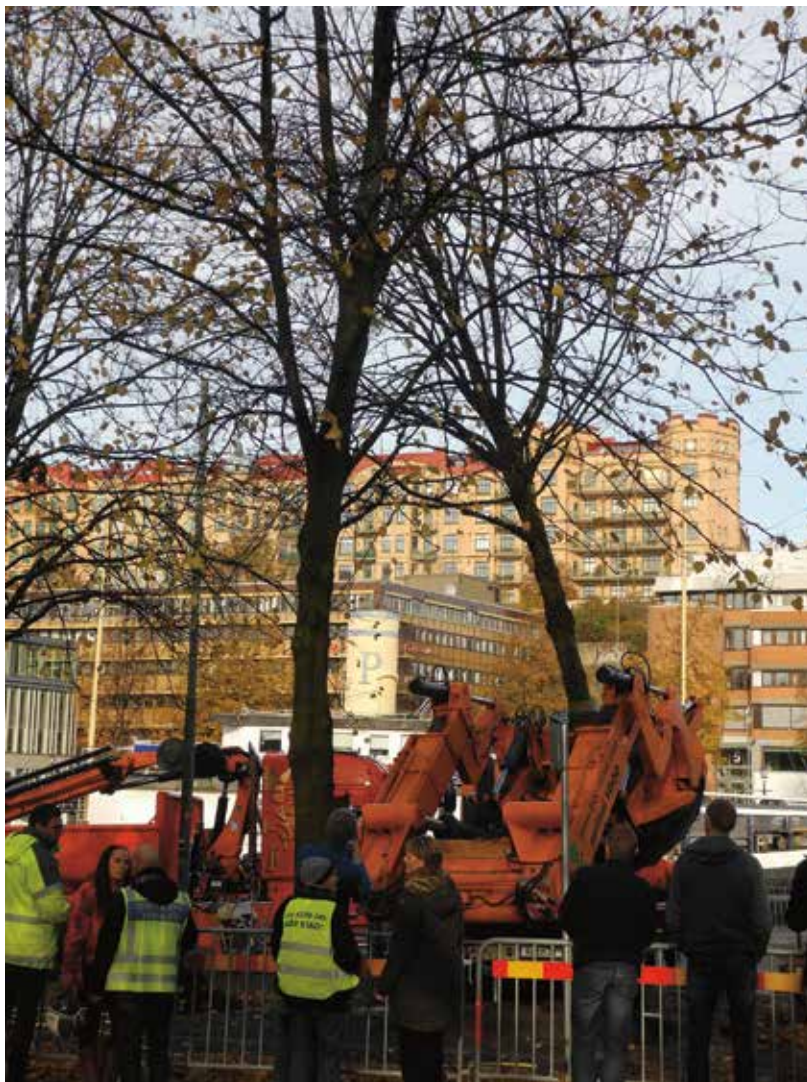
Allt kan inte äga rummet samtidigt. Trafikverket provar att flytta träd vid byggandet av Haga station, en del av den kontroversiella tåg tunneln Västlänken som dras genom centrala Göteborg. Foto: Mattias Sandberg.
