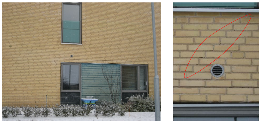
Bild 7.1. Murverksbalk med stor spännvidd (vänster); detalj med sned skjvspricka (höger). Kommentar – de urfrästa murfogarna håller på att lagas.
