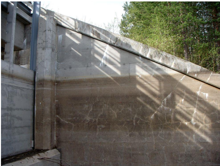
Figur 40 AKR-skadad konstruktion med varierande sprickfält.
