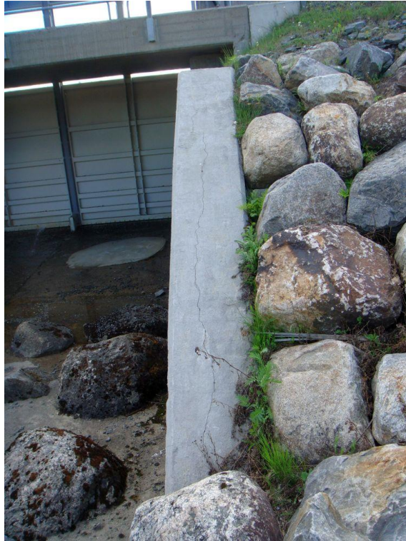
Figur 41 AKR-skadad konstruktion med sprickplan som löper parallellt med huvudarmeringar.
