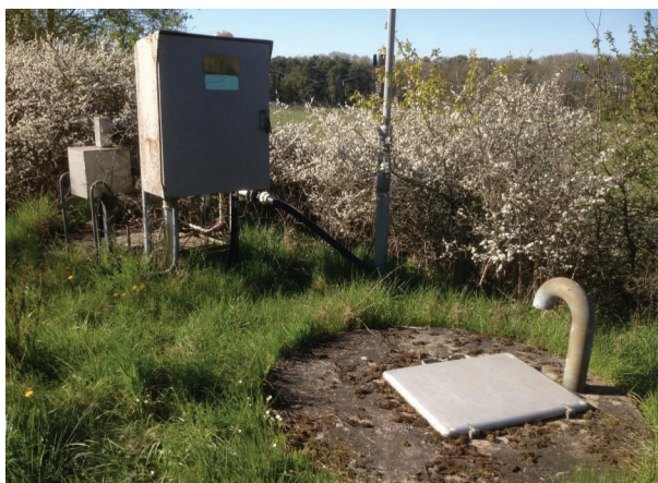
Fig. 2. Pumpstationen som antingen pumpar vatten till det närliggande reningsverket eller upp till deponin för att bevattna dess växtlighet. Foto: Daniel Persson.
