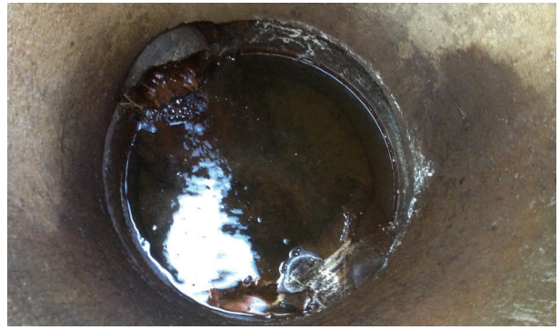
Fig. 18. Dräneringsbrunn där vattnet uppfattades skumma svagt. Foto: Daniel Persson
