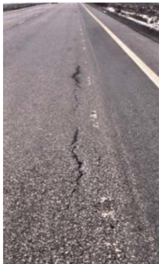
Figur 1 Sprickbildning i hjulspår (SKR 2019)
