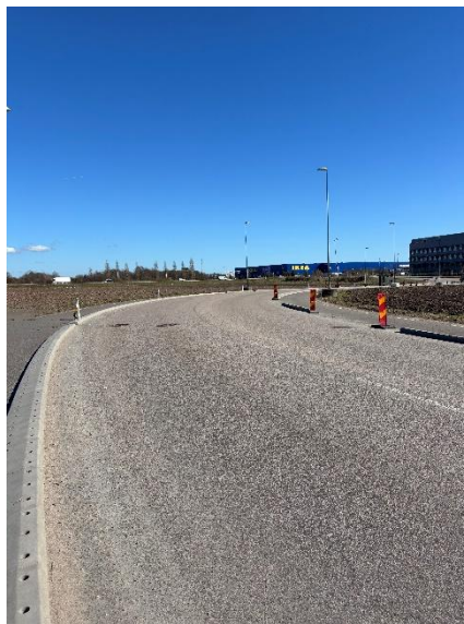
Figur 16. Hyllie Boulevard med skadade stöd i innerkurva. Källa: privat foto.
