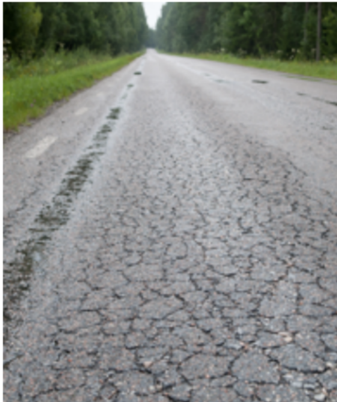
Figur 21. Krackelerings skada på en väg (SKR 2019).
