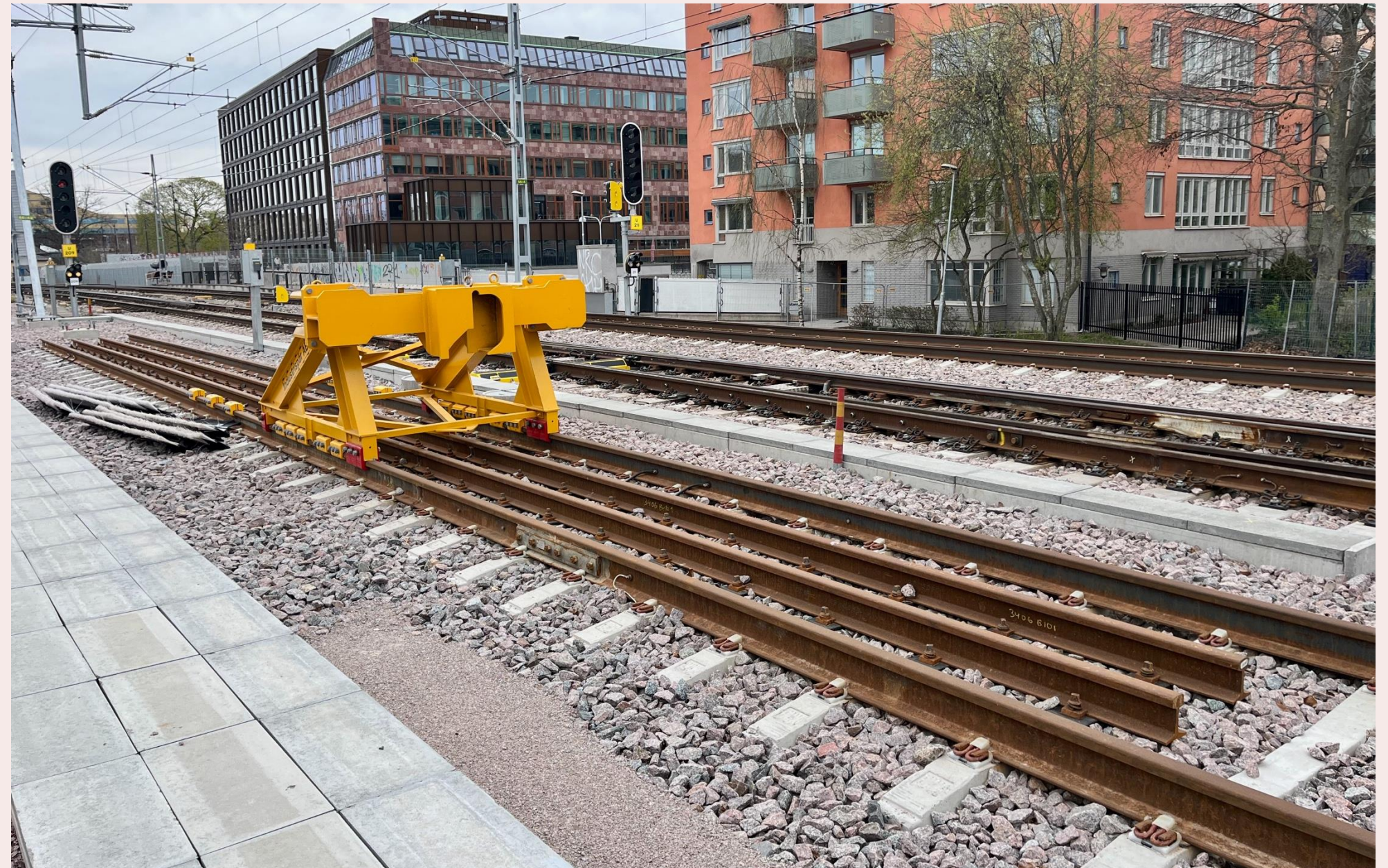
Förstärkt spår med GULO-stoppbock på skyddsspår i Uppsala
