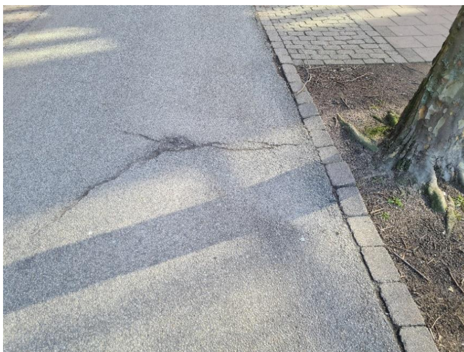
Figur 4: Rotskada på cykelbana (Kaptensgatan, 2026-03-18).
