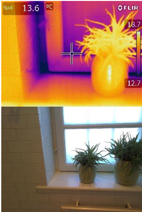
Figur 4: Termograferingsbild 3 – Badrum, plan 2 (tegelvägg norr)
