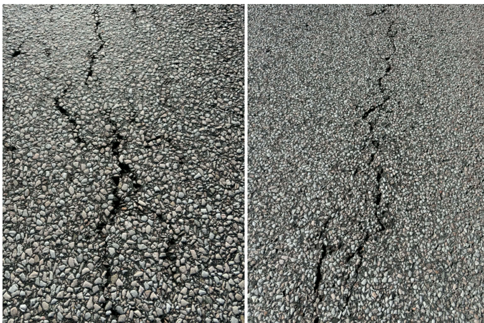
Figur 11: Sprickbildning i hjulspår på E6 (vänster bild) och på E45 (höger bild).
