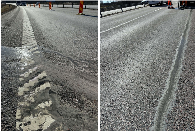
Figur 12: Avrinning av vatten på delsträckorna på E6 (vänster bild). Delsträckorna på E45 hade vatten som samlades i hjulspåren (höger bild).
